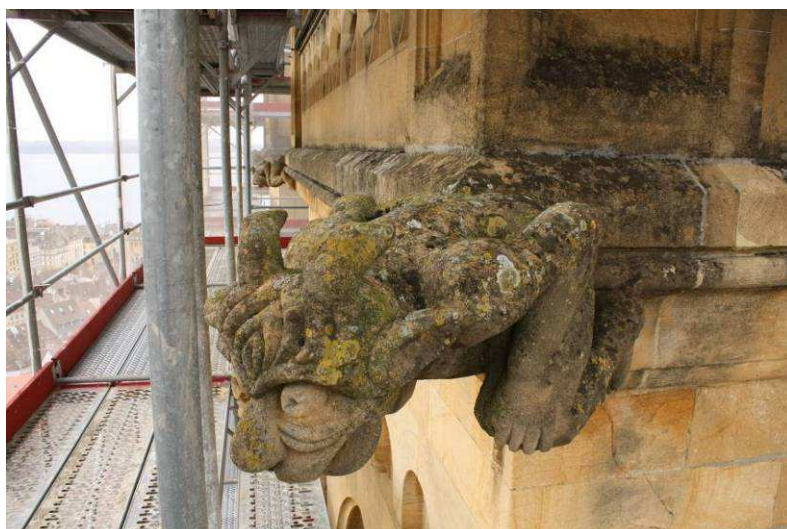
Gargouille au Nord-Est de la tour Nord
